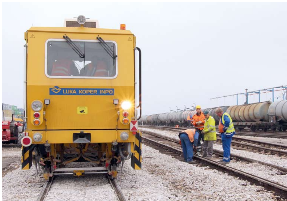
Podbijalka je poseben stroj za višinsko in stransko regulacijo tirov; njegova medosna razdalja je 7 metrov, dolžina 10,4 metra, masa pa 23 ton
