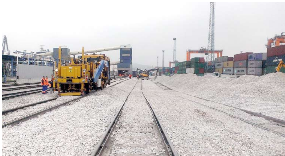
S podbijalko so opravili vsa potrebna dela na dveh novih in treh obstoječih tirih na kontejnerskem terminalu
