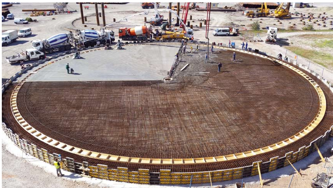
Pod temeljno ploščo za rezervoar s premerom 42 metrov in debeline enega metra so zabili 113 jeklenih pilotov 36 metrov globoko, v samo ploščo pa vgradili 2000 m 3 betona in 250 ton železa
