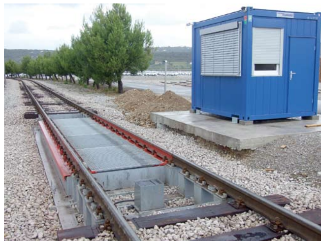
Najnovejša je tehtnica ob tiru 41. To je tehtnica z dinamičnim načinom tehtanja vagonov z uporabo enega tehtalnega modula dolžine 6 metrov, na katerem je možno tehtanje vseh tipov vagonov, razen vagonov, ki prevažajo tekočine. Upravljajo jo na daljavo iz centralne tehtalne hiše.
