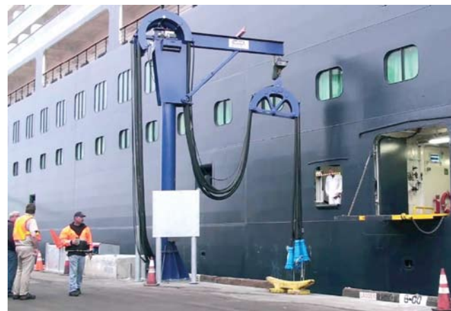
Primer izvedenega fiksnega priklopa potniške ladje na električno omrežje
