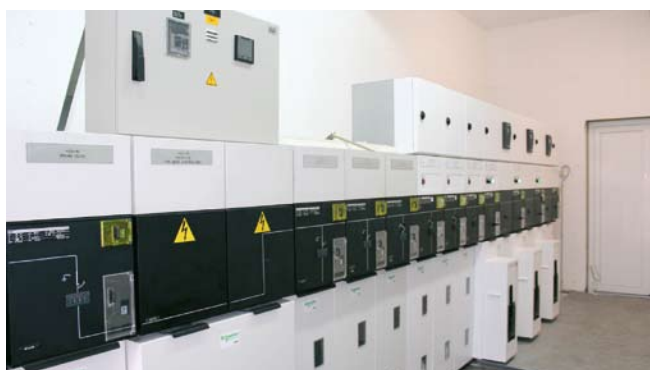
Prostor s sredjenapetostnimi (20.000V) omaricami, desno so odklopniki za napajanje RMG dvigal, pripravljen je že tudi prostor za novo kontejnersko dvigalo
