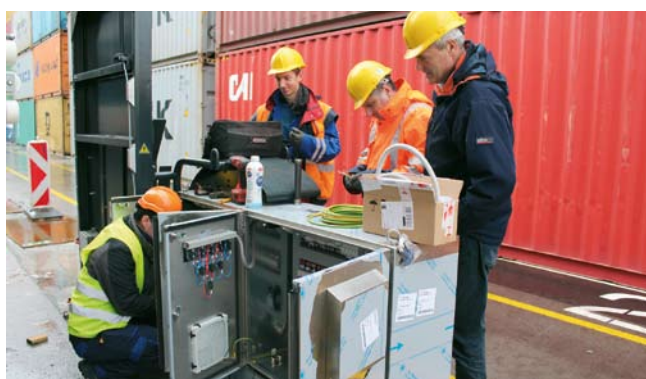
Za elektromontažna dela razširitve transformatorske postaje je bila izbrana hčerinska družba Luka Koper INPO. Ekipe se je morala ves čas prilagajati delu na terminalu, ki je moralo potekati neprekinjeno.
