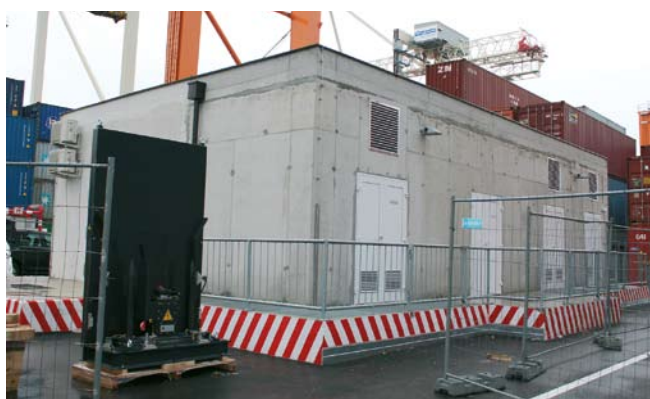
Za tako velike odjemalce električne energije smo morali povečati tudi zmogljivost transformatorske postaje
