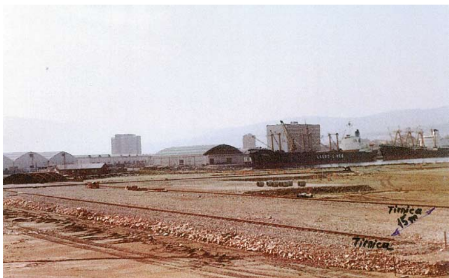
Avгust 1970: urejanje platoja z nasipavanjem in postavljanje tira v razmiku 15 metrov za portalne žerjave pred prvim pomolom za delovišče Metalne Maribor; na sliki sta lepo vidni stavbi Intereurope in stavba tedanjega skladišča blagovnih rezerv.
