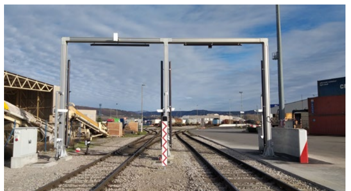
Portal za optično prepoznavanje kontejnerjev.
